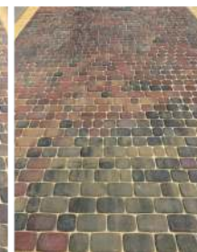
niewłaściwe ułożenie kostki
