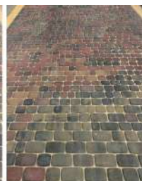
niewłaściwe ułożenie kostki
